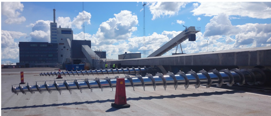
Figur 10. Transportskruvar för inmatning av bränsle till transportgången. Foto tillhandahållet av Krafringen AB.
