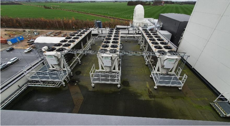
FIGUR 5: TAKKYLARE TURBINHALL 3 ST, VY MOT ÖSTER.
