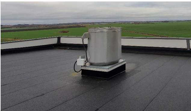
FIGUR 4: FRÅNLUFTSFLÄKT FRÅN TURBINHALL 1 AV 5, VY MOT NORDOST.
