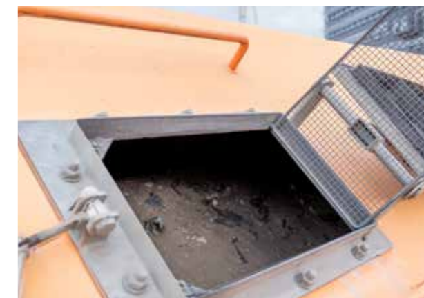
På Örtoftaverkets bränslegård står orangea containrar. I dem mellanlagras vi askan från förbränningspannans botten. Askan består till största delen av nersotad sand och metallrester från det returträ vi förbränner.
